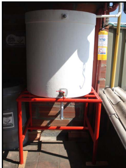
Fotografía 1. Sistema de captación y aprovechamiento de aguas lluvias.
