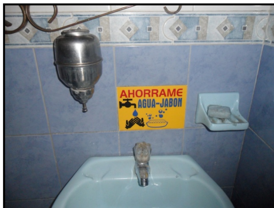
Fotografía 8. Llave de bajo consumo instalada en los lavamanos habilitados al servicio de los clientes de la empresa.
