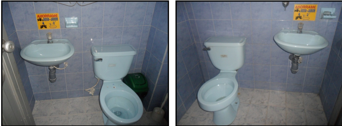
Fotografías 2 y 3. Sanitarios de bajo consumo instalados en los baños al servicio de los clientes de la empresa.
