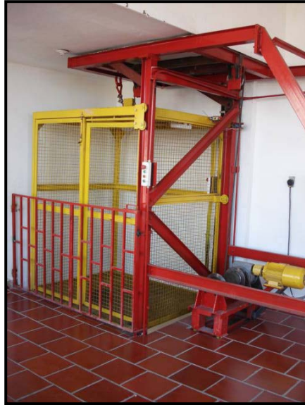
Fotografía 14. Sistema elevador de la empresa.
