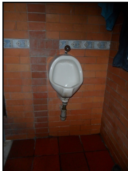
Fotografía 4. Orinal instalado en el baño de empleados de la empresa.
