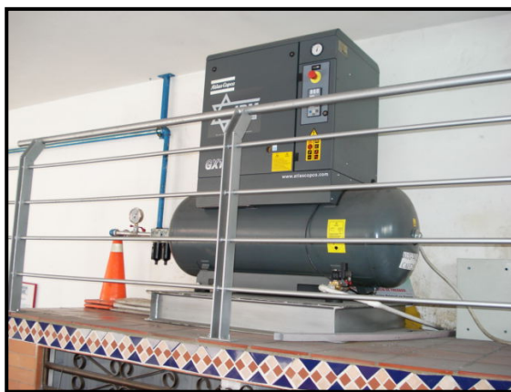
Fotografía 13. Compresor de la empresa.
